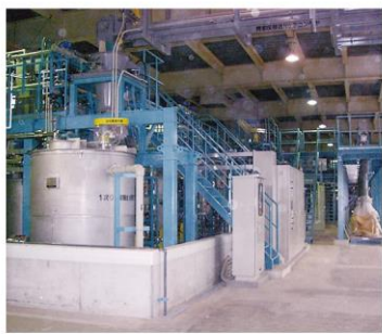
下水汚泥焼却灰中のリン酸回収プラント（岐阜市）
