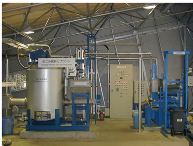
写真3-1 生ごみ肥料「みどりくん」の製造プラント
